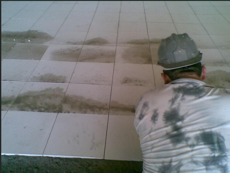
Falta de rejunte
